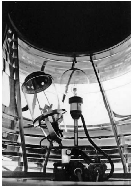
Equipo eléctrico-gas del faro de Adra. Foto Felipe Ortiz.
