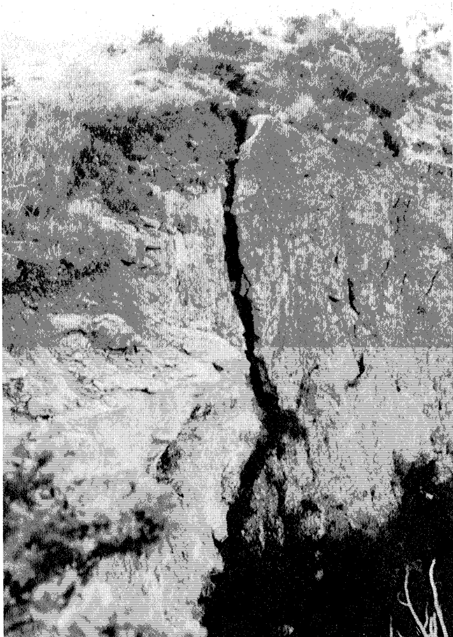
Ejemplo de desprendimiento de bloques en las calcarenitas (término 3 de la serie).
