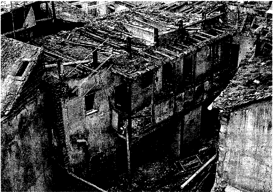
Cuerpo interior de una "corrala" en ruina (1981)
